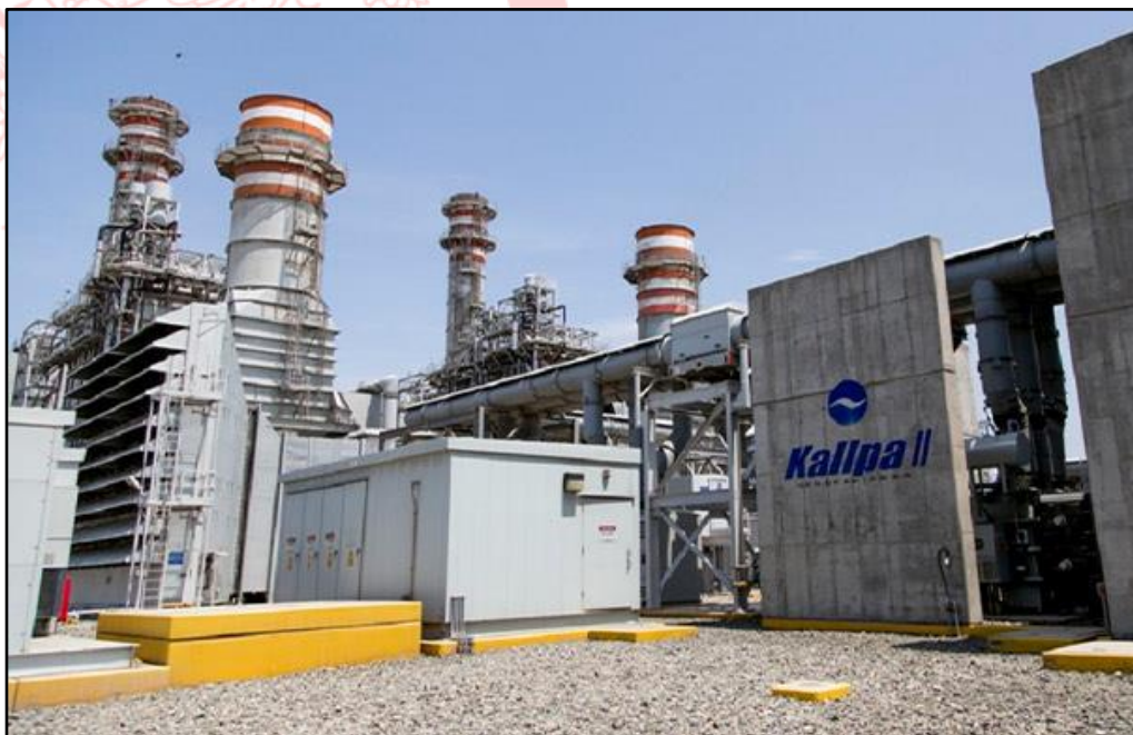
CENTRAL TÉRMICA KALLPA – LIMA
