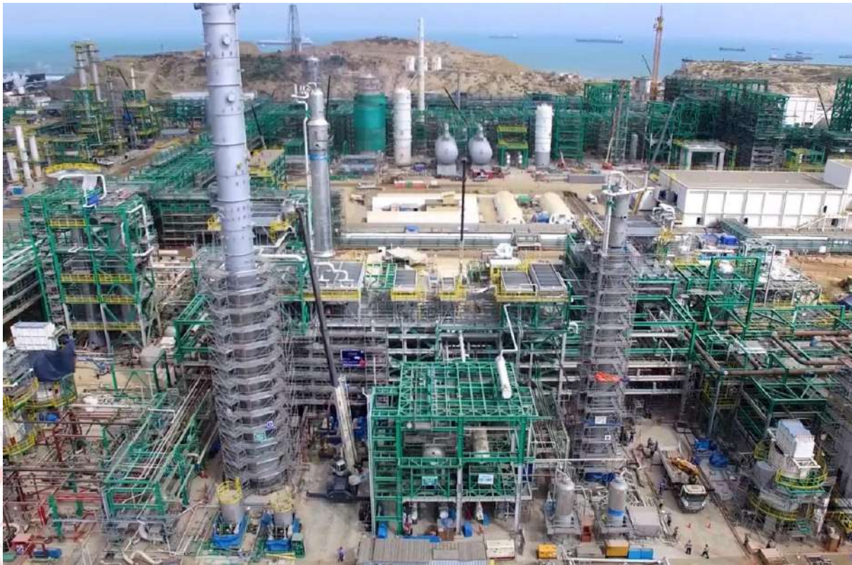
REFINERÍA DE TALARA
