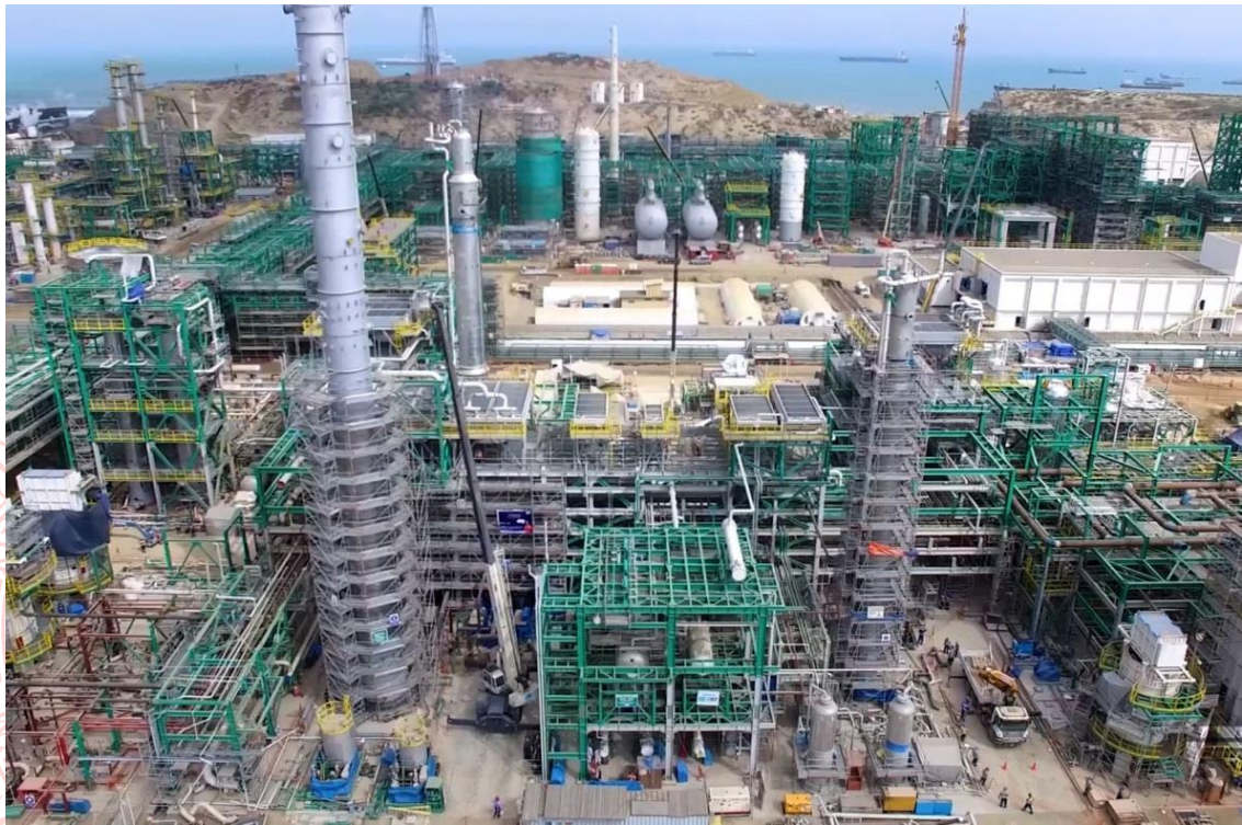
REFINERÍA DE TALARA
